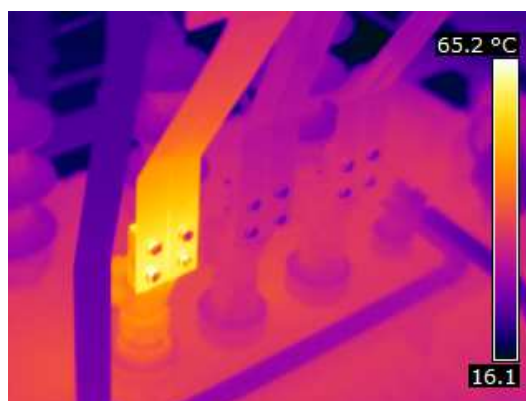
Anomalia nell'accoppiamento tra il passante del trasformatore e le barre bt.
