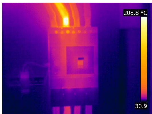
Alto rischio di incendio a causa dell'elevata temperatura misurata su una fase d'ingresso all'interruttore.
