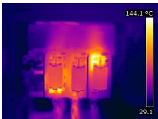
Anomala resistenza di contatto in una terna di fusibili con elevata temperatura su una fase.
